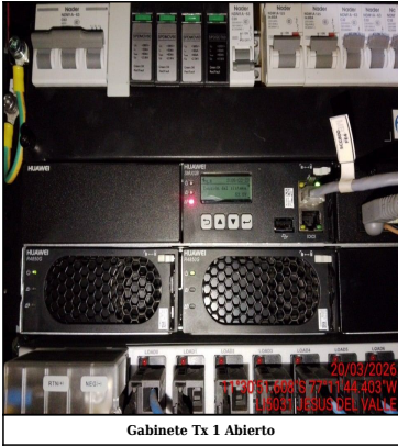
Gabinete Tx 1 Abierto
