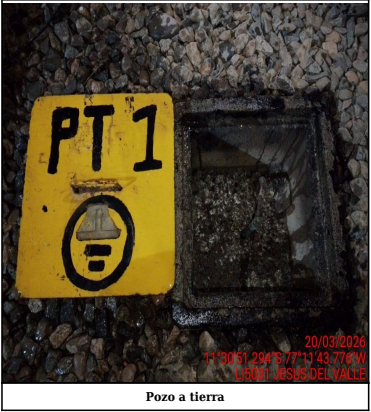
Pozo a tierra
