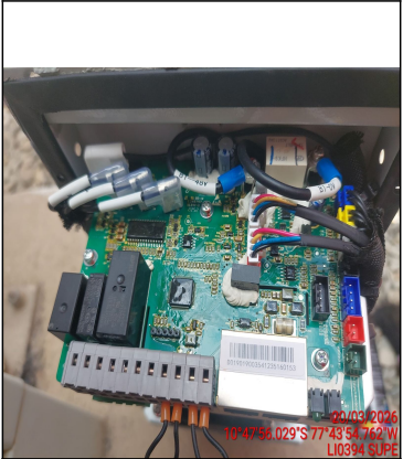
FOTO DE COMPONENTES DE UE (PARTE ELECTRICA)
