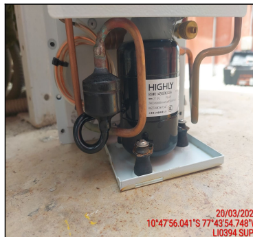
FOTO CORRIENTE REAL EN COMPRESOR
