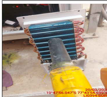
FOTO LIMPIEZA Y ESTADO DE SERPENTIN DE UC
