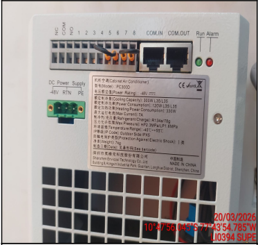
FOTO DE PLACA DE UNIDAD EVAPORADORA
