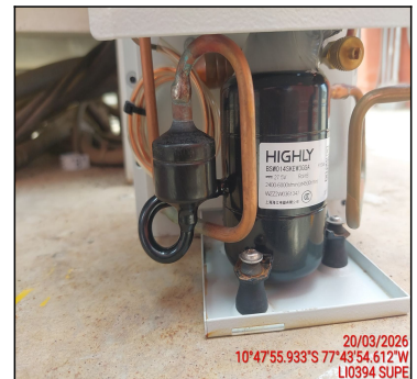
FOTO CORRIENTE SEGUN PLACA COMPRESOR
