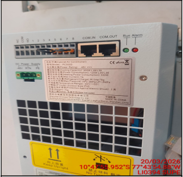
FOTO DE PLACA DE UNIDAD CONDENSADORA
