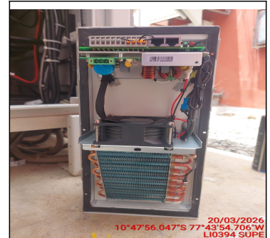
FOTO COMPONENTES DE UC (PARTE ELECTRICA)
