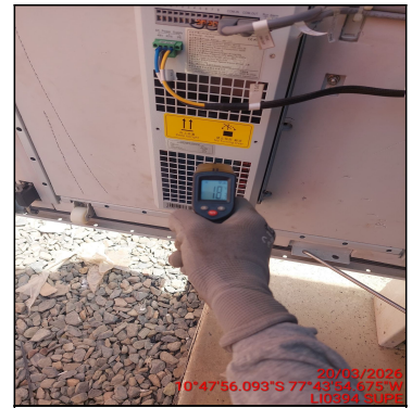
FOTO TEMPERATURA DE EXPULSION
