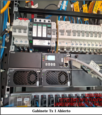
Gabinete Tx 1 Abierto
