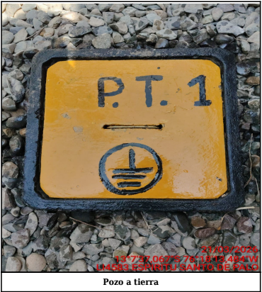
Pozo a tierra
