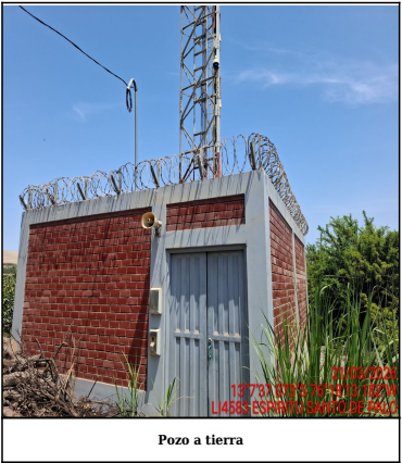
Pozo a tierra
