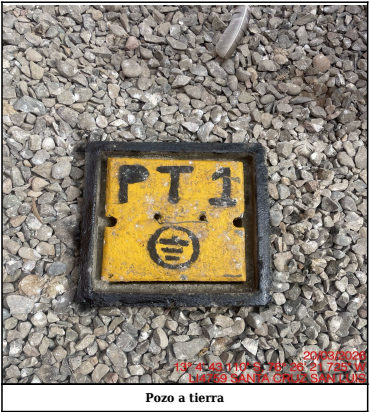
Pozo a tierra
