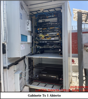
Gabinete Tx 1 Abierto
