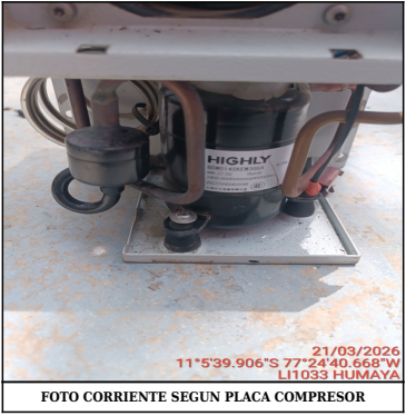
FOTO CORRIENTE SEGUN PLACA COMPRESOR
