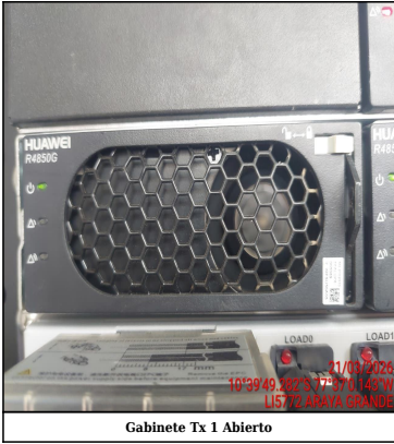
Gabinete Tx 1 Abierto
