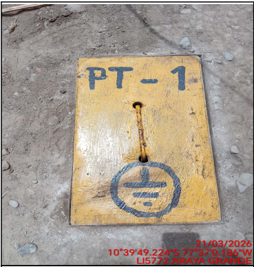
Pozo a tierra
