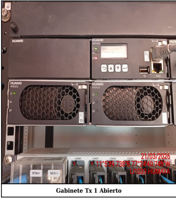
Gabinete Tx 1 Abierto
