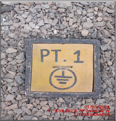
Pozo a tierra
