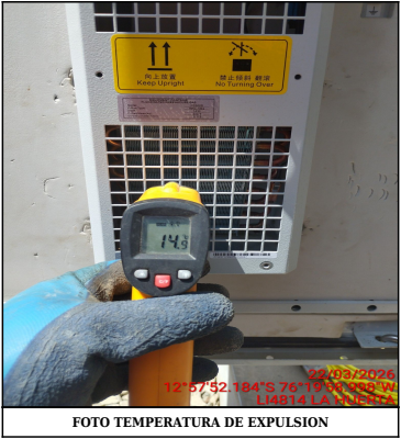
FOTO TEMPERATURA DE EXPULSION
