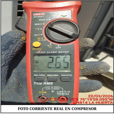
FOTO CORRIENTE REAL EN COMPRESOR
