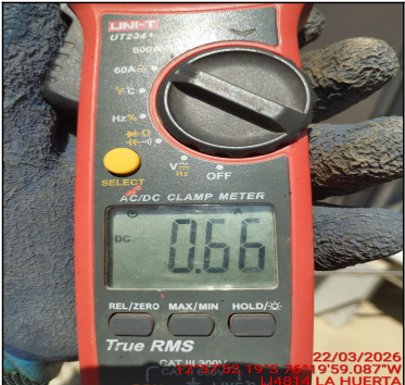
FOTO CORRIENTE REAL EN MOTOR VENTILADOR
