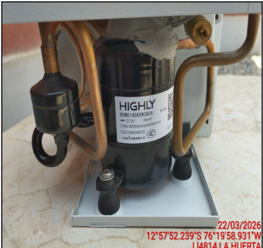
FOTO DE COMPRESOR
