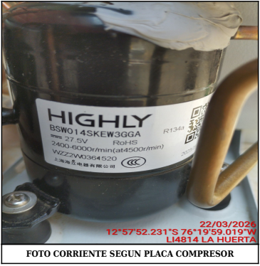
FOTO CORRIENTE SEGUN PLACA COMPRESOR
