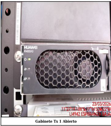
Gabinete Tx 1 Abierto
