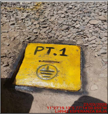
Pozo a tierra
