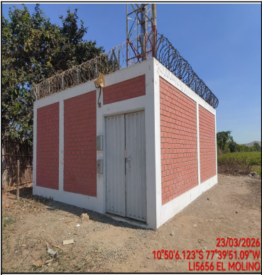
Pozo a tierra
