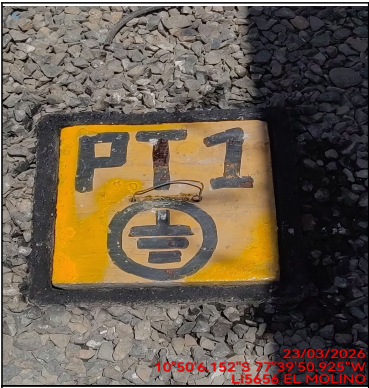
Pozo a tierra
