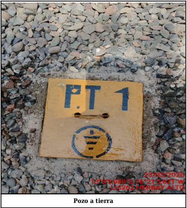
Pozo a tierra
