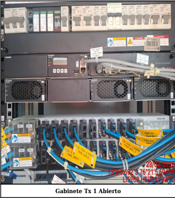
Gabinete Tx 1 Abierto
