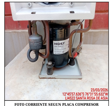
FOTO CORRIENTE SEGUN PLACA COMPRESOR
