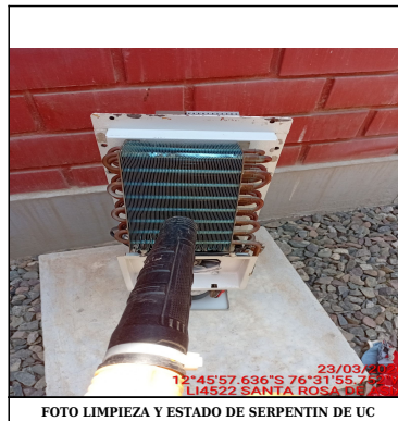
FOTO LIMPIEZA Y ESTADO DE SERPENTIN DE UC
