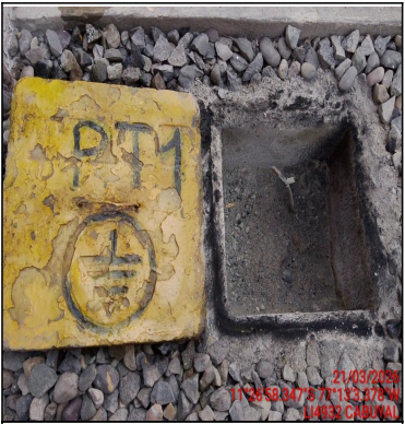
Pozo a tierra
