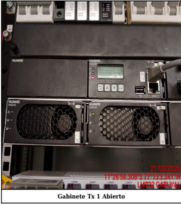
Gabinete Tx 1 Abierto
