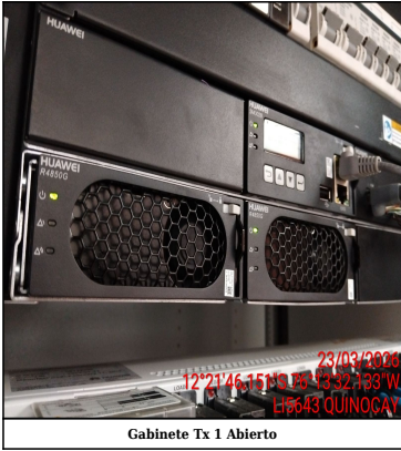
Gabinete Tx 1 Abierto
