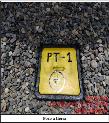
Pozo a tierra
