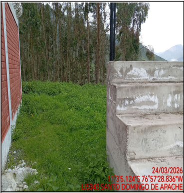
Pozo a tierra
