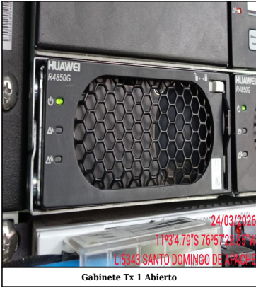
Gabinete Tx 1 Abierto
