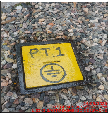
Pozo a tierra
