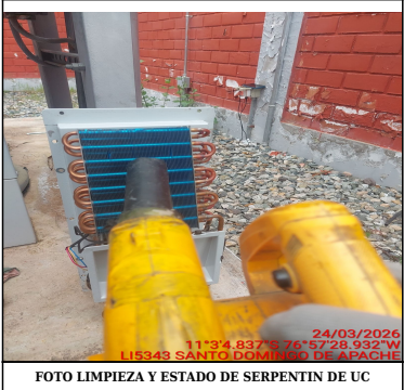
FOTO LIMPIEZA Y ESTADO DE SERPENTIN DE UC
