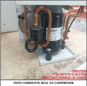
FOTO CORRIENTE REAL EN COMPRESOR
