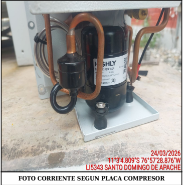
FOTO CORRIENTE SEGUN PLACA COMPRESOR
