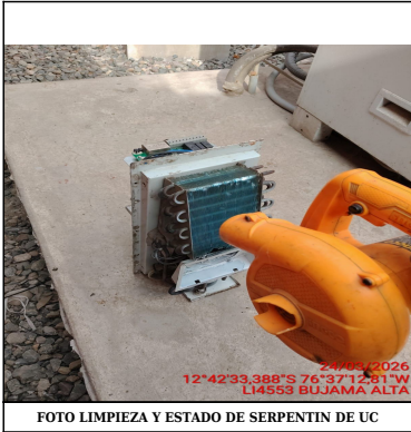
FOTO LIMPIEZA Y ESTADO DE SERPENTIN DE UC
