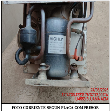
FOTO CORRIENTE SEGUN PLACA COMPRESOR
