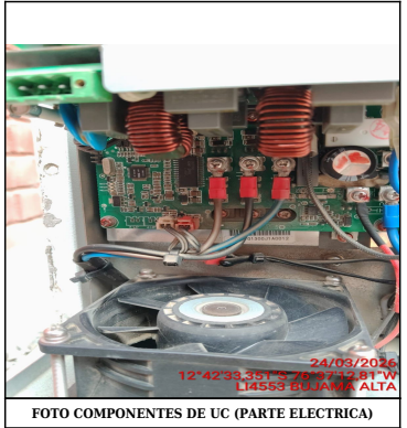
FOTO COMPONENTES DE UC (PARTE ELECTRICA)
