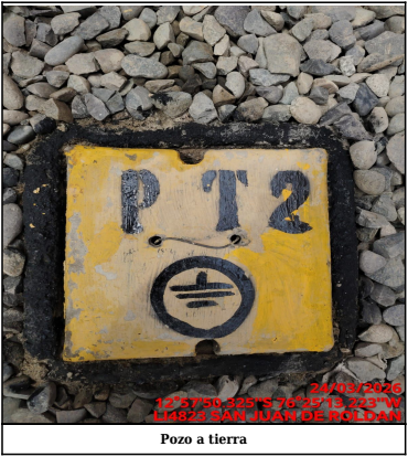
Pozo a tierra
