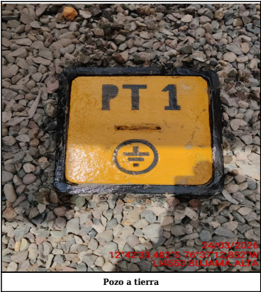
Pozo a tierra
