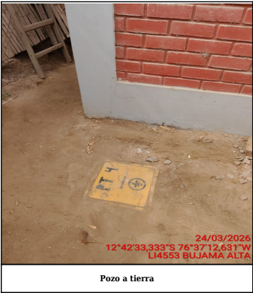
Pozo a tierra
