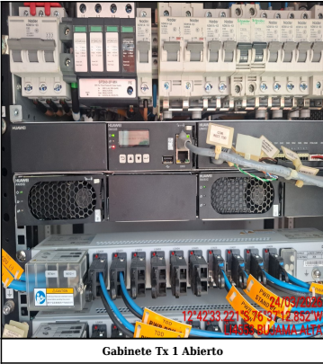
Gabinete Tx 1 Abierto
