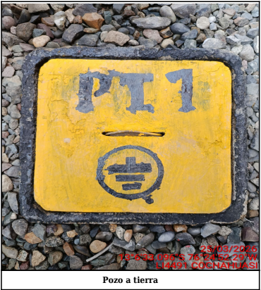
Pozo a tierra
