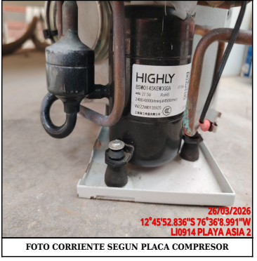
FOTO CORRIENTE SEGUN PLACA COMPRESOR
