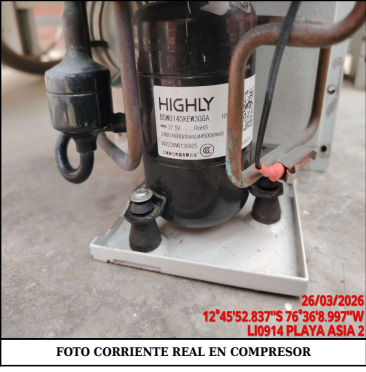
FOTO CORRIENTE REAL EN COMPRESOR
