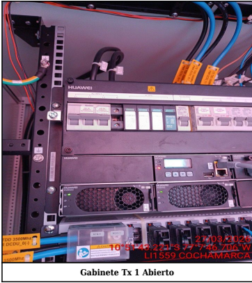
Gabinete Tx 1 Abierto
