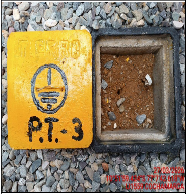
Pozo a tierra
