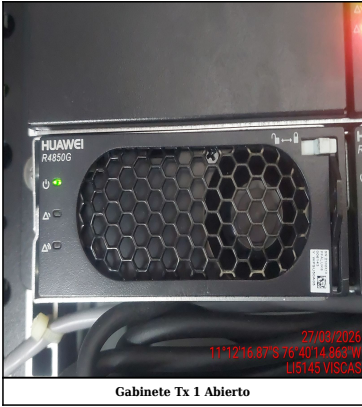
Gabinete Tx 1 Abierto
