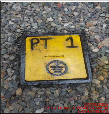
Pozo a tierra
