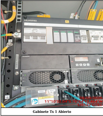
Gabinete Tx1 Abierto
