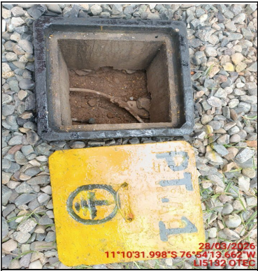
Pozo a tierra
