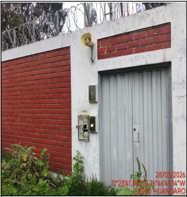
Pozo a tierra
