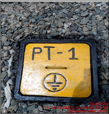
Pozo a tierra
