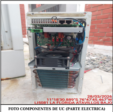
FOTO COMPONENTES DE UC (PARTE ELECTRICA)
