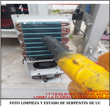
FOTO LIMPIEZA Y ESTADO DE SERPENTIN DE UC
