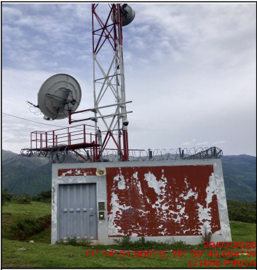
Pozo a tierra
