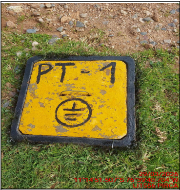
Pozo a tierra
