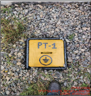
Pozo a tierra
