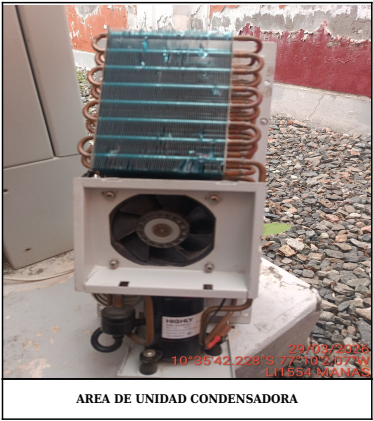
AREA DE UNIDAD CONDENSADORA
