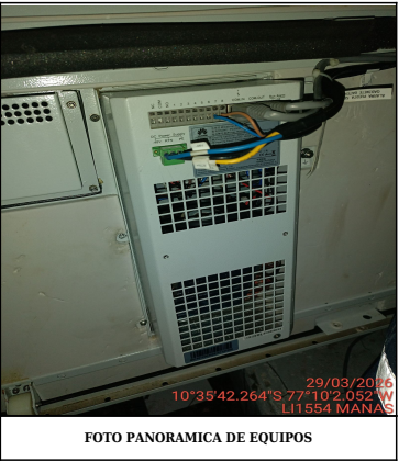
FOTO PANORAMICA DE EQUIPOS
