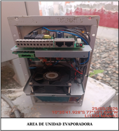
AREA DE UNIDAD EVAPORADORA
