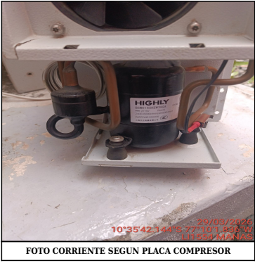
FOTO CORRIENTE SEGUN PLACA COMPRESOR
