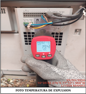
FOTO TEMPERATURA DE EXPULSION
