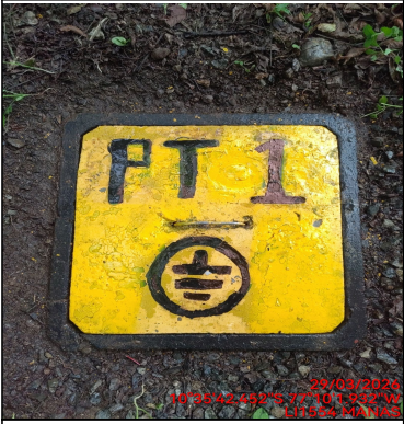
Pozo a tierra
