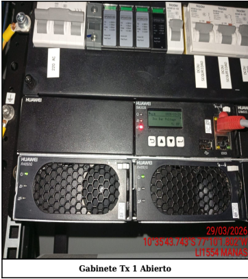
Gabinete Tx 1 Abierto
