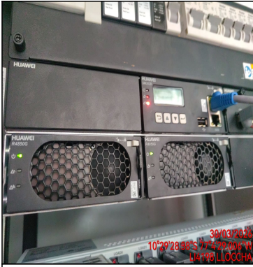
Gabinete Tx 1 Abierto
