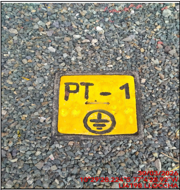
Pozo a tierra
