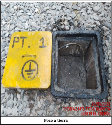
Pozo a tierra
