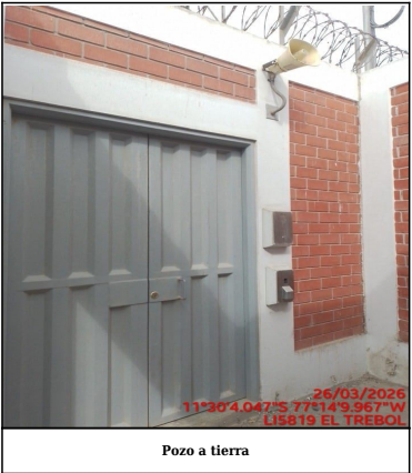
Pozo a tierra
