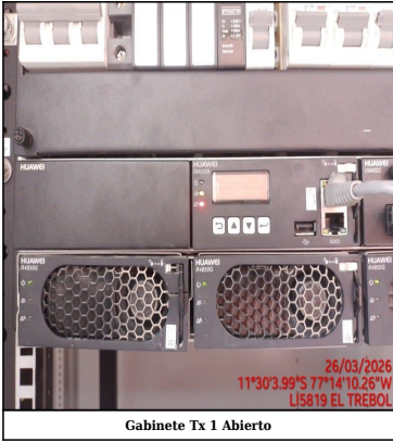
Gabinete Tx 1 Abierto
