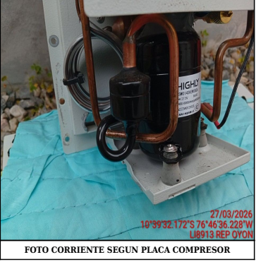
FOTO CORRIENTE SEGUN PLACA COMPRESOR
