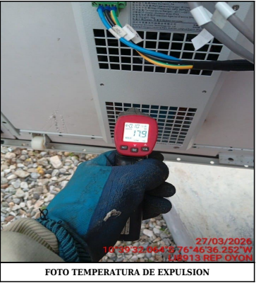
FOTO TEMPERATURA DE EXPULSION
