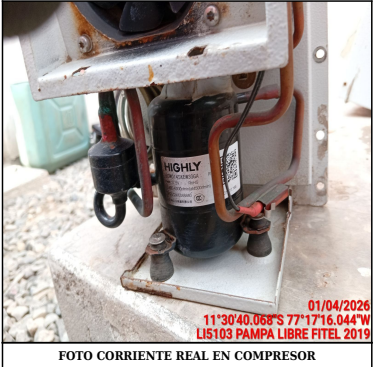
FOTO CORRIENTE REAL EN COMPRESOR
