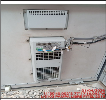
FOTO COMPONENTES DE UC (PARTE ELECTRICA)
