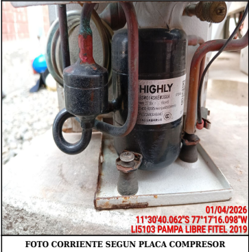
FOTO CORRIENTE SEGUN PLACA COMPRESOR
