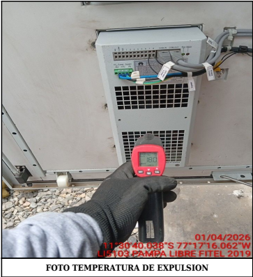
FOTO TEMPERATURA DE EXPULSION
