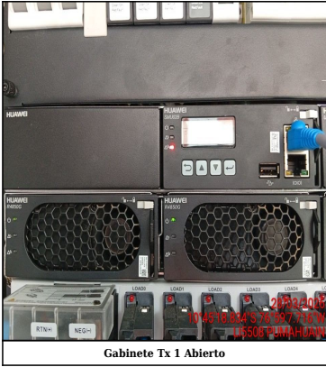
Gabinete Tx 1 Abierto
