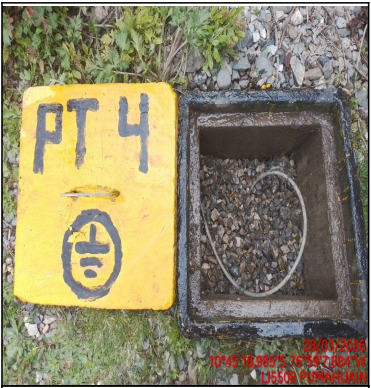
Pozo a tierra
