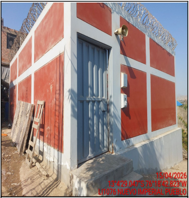
Pozo a tierra
