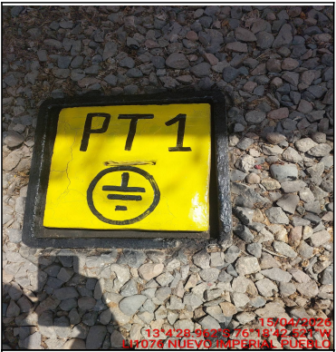
Pozo a tierra
