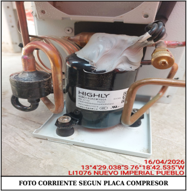
FOTO CORRIENTE SEGUN PLACA COMPRESOR
