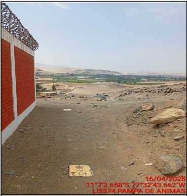
Pozo a tierra
