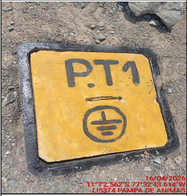
Pozo a tierra
