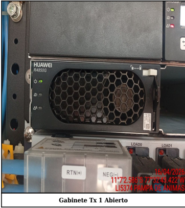
Gabinete Tx 1 Abierto
