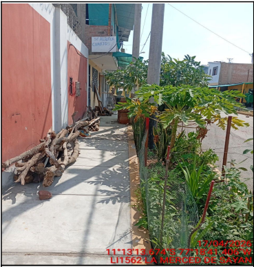
Pozo a tierra
