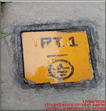
Pozo a tierra
