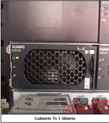
Gabinete Tx 1 Abierto
