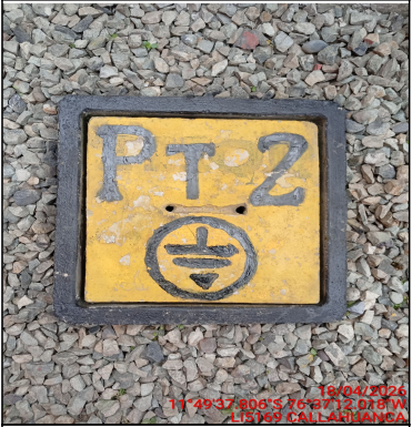
Pozo a tierra
