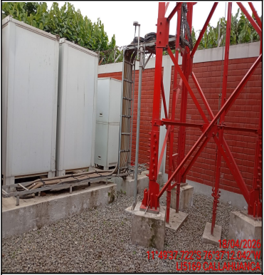
Pozo a tierra
