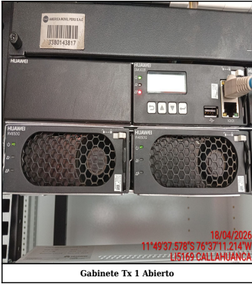
Gabinete Tx 1 Abierto
