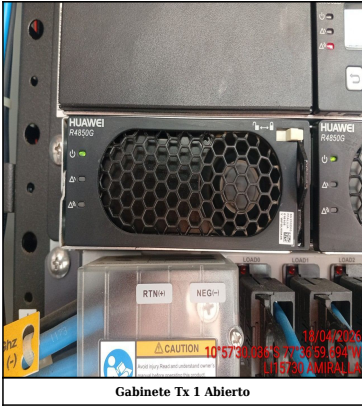
Gabinete Tx 1 Abierto
