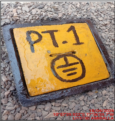
Pozo a tierra
