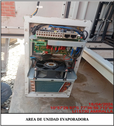
AREA DE UNIDAD EVAPORADORA
