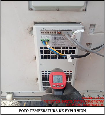
FOTO TEMPERATURA DE EXPULSION
