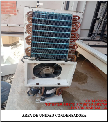
AREA DE UNIDAD CONDENSADORA
