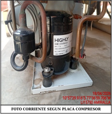
FOTO CORRIENTE SEGUN PLACA COMPRESOR
