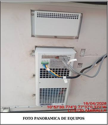
FOTO PANORAMICA DE EQUIPOS
