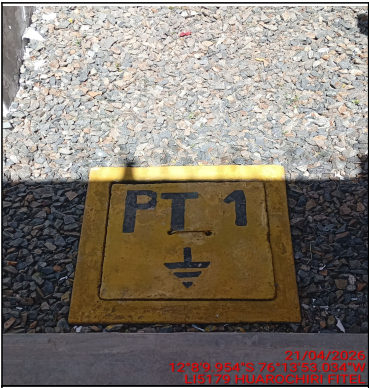
Pozo a tierra
