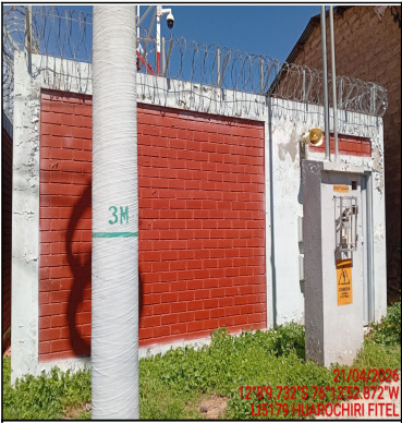
Pozo a tierra
