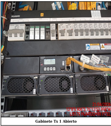
Gabinete Tx 1 Abierto
