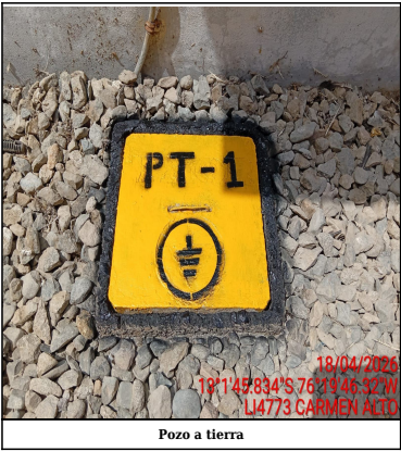
Pozo a tierra
