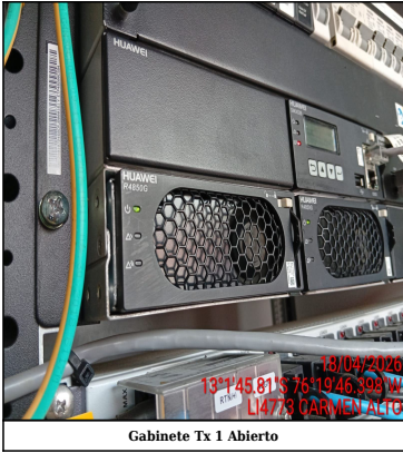
Gabinete Tx 1 Abierto
