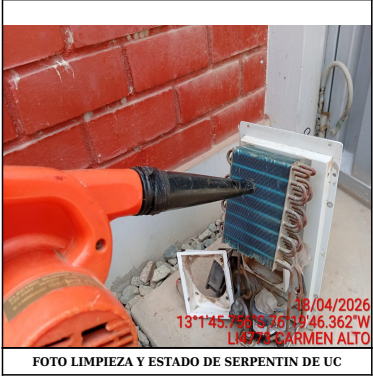
FOTO LIMPIEZA Y ESTADO DE SERPENTIN DE UC
