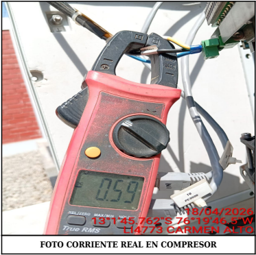
FOTO CORRIENTE REAL EN COMPRESOR
