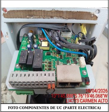
FOTO COMPONENTES DE UC (PARTE ELECTRICA)
