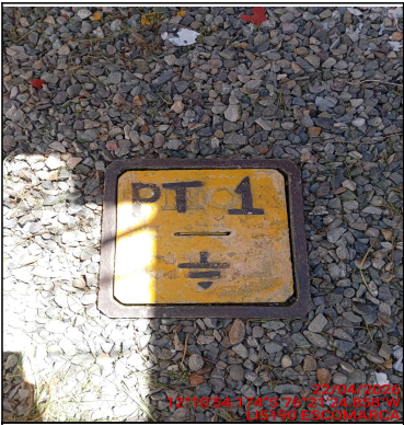
Pozo a tierra
