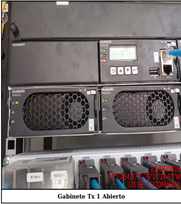
Gabinete Tx 1 Abierto
