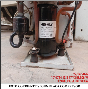
FOTO CORRIENTE SEGUN PLACA COMPRESOR
