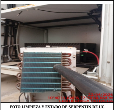
FOTO LIMPIEZA Y ESTADO DE SERPENTIN DE UC
