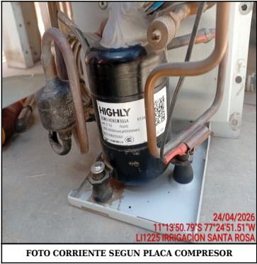
FOTO CORRIENTE SEGUN PLACA COMPRESOR
