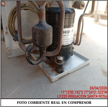
FOTO CORRIENTE REAL EN COMPRESOR
