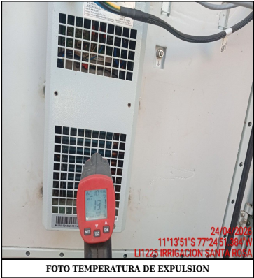
FOTO TEMPERATURA DE EXPULSION
