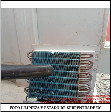
FOTO LIMPIEZA Y ESTADO DE SERPENTIN DE UC
