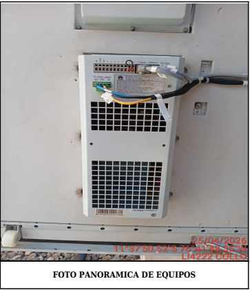
FOTO PANORAMICA DE EQUIPOS
