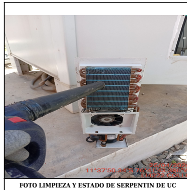
FOTO LIMPIEZA Y ESTADO DE SERPENTIN DE UC
