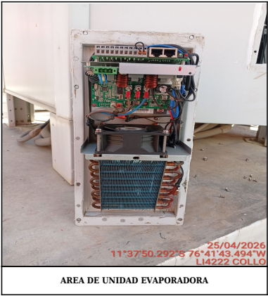
AREA DE UNIDAD EVAPORADORA
