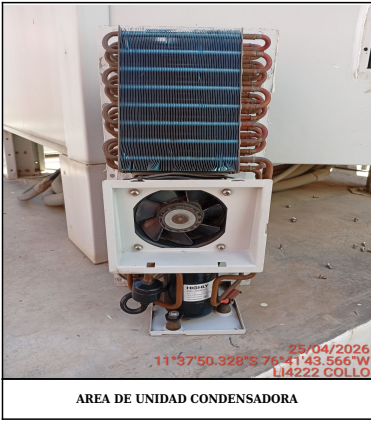
AREA DE UNIDAD CONDENSADORA
