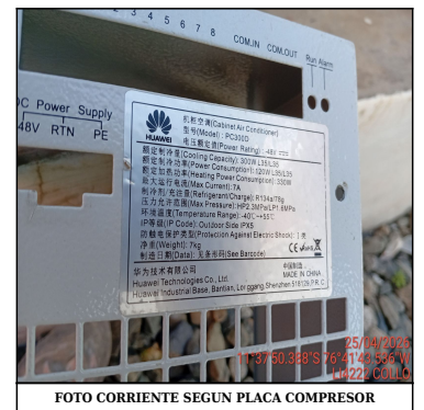
FOTO CORRIENTE SEGUN PLACA COMPRESOR
