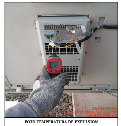
FOTO TEMPERATURA DE EXPULSION
