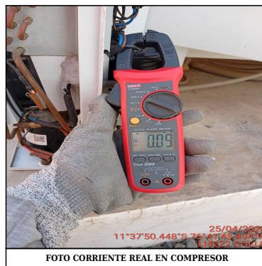
FOTO CORRIENTE REAL EN COMPRESOR
