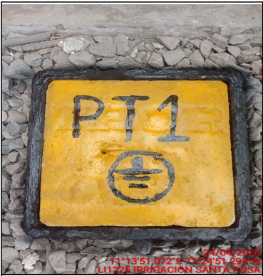
Pozo a tierra
